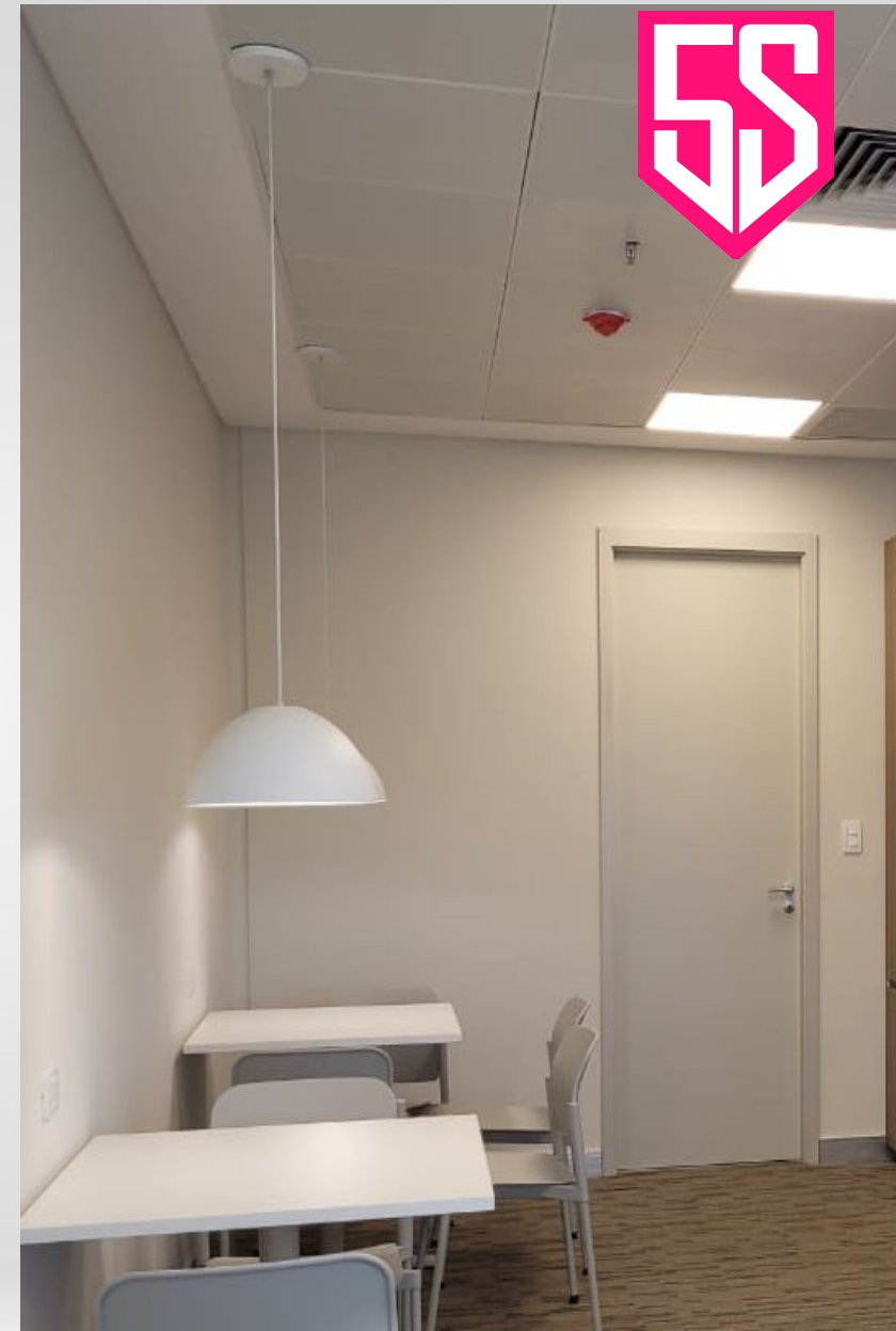
DREYFUS, WORLD TRADE CENTER - Provisión y colocación de cielorraso, instalación de tabiques de durlock.
